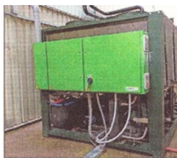
Propaan-koelinstallatie op een akkerbouwbedrijf. Foto RB
